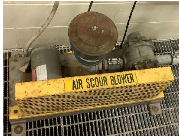
Air Scour Blower
