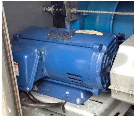
AHU-1 Supply Fan Motor
