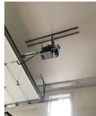
Garage Door Motor
