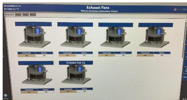
BAS Exhaust Fan Status
