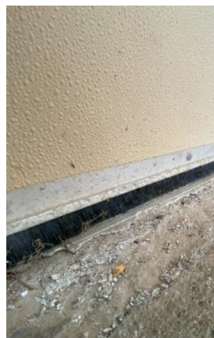
Intact Door Seals
