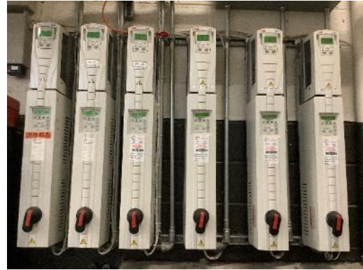
Exhaust Fan VFDs
