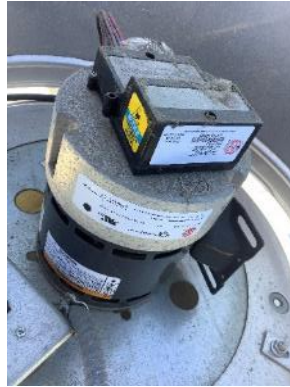
VFD Exhaust Fan
