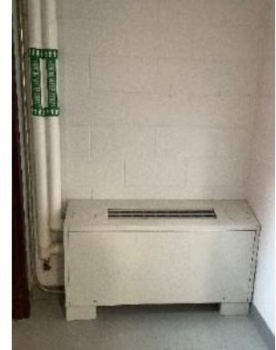
Fan Coil Unit
