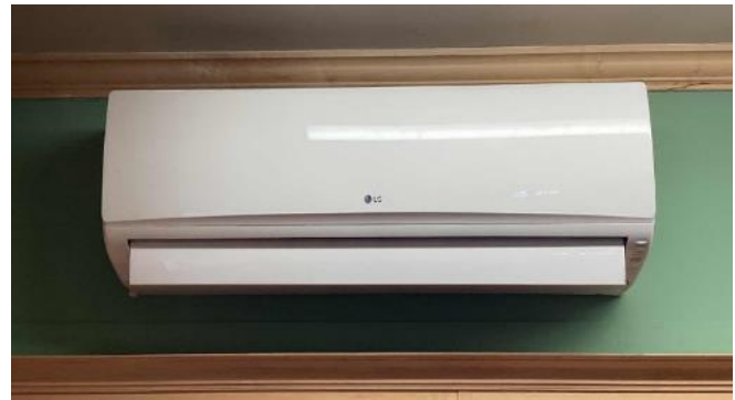
Fan Coil Unit
