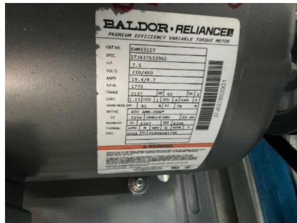
Supply Fan Motor
