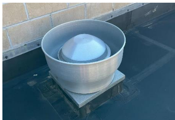
Roof Exhaust Fan
