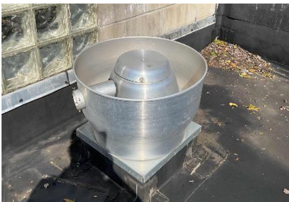
Roof Exhaust Fan
