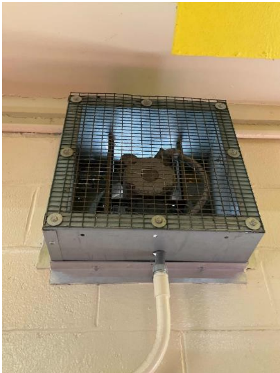
Exhaust Fan at Hawkins
