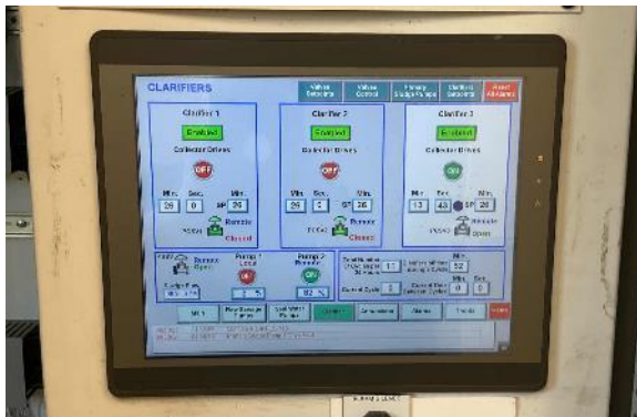
Clarifier: Control System
