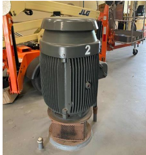
Sludge Return Pump-2
