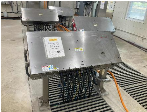
U.V. Bank 1B – U.V. Disinfection
