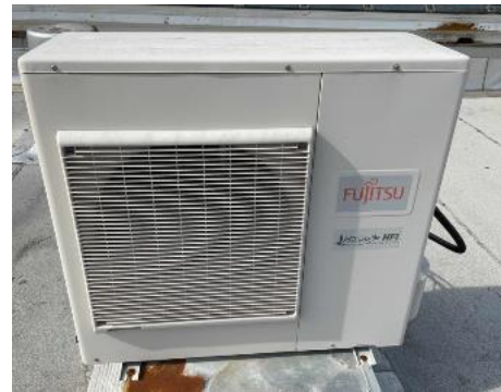
Ductless Mini AC Unit
