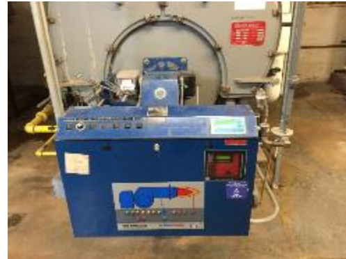
Boiler Draft Fan
