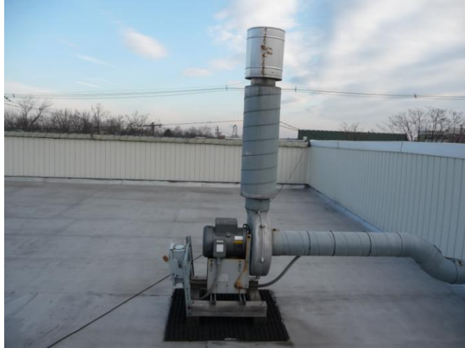
Rooftop van / truck exhaust fan
